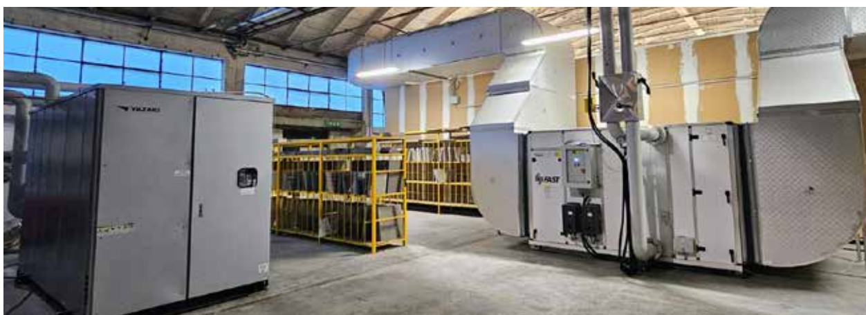
Assorbitore e Unità di Trattamento Aria, stabilimento Cerdomus, Castel Bolognese (RA)
